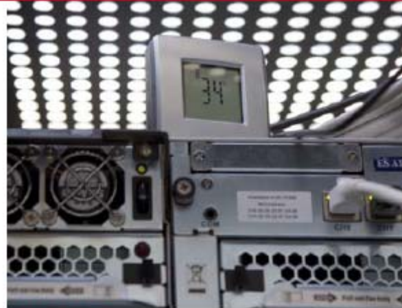
34°C im Rechenzentrum
